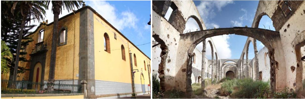
Fig. 2 Fachada principal y muros aún en pie pertenecientes a la iglesia de San Agustín, junto al antiguo convento de la misma orden, en su estado actual, luego de que el incendio de 1964 consumiera su interior e hiciera desplomarse tu techo. Su ubicación marcaba el límite suroriental de la antigua ciudad, hasta el momento en que comenzó a construirse la Villa de Abajo. Fotografías del autor.
